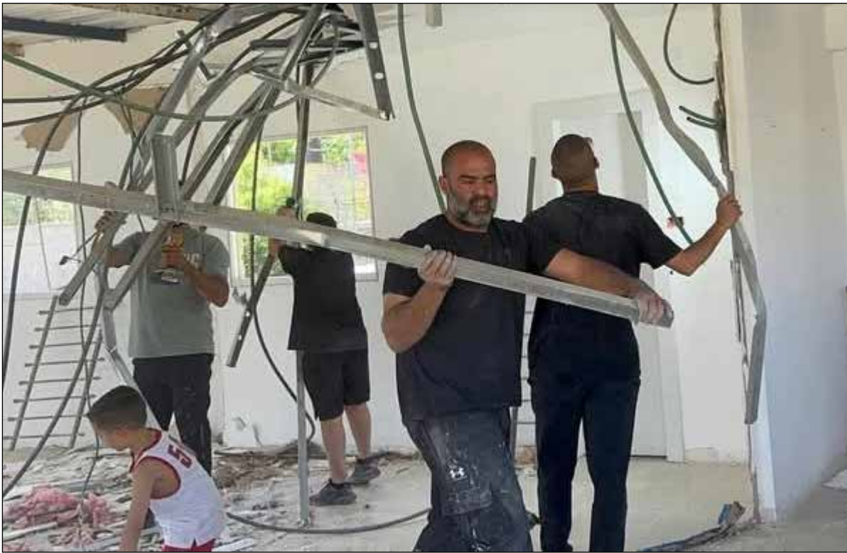
مواطن مقدسي يهدم منزل والدته قسراً بقرار من الاحتلال في بلدة سلوان بالقدس المحتلة (فلسطين)
